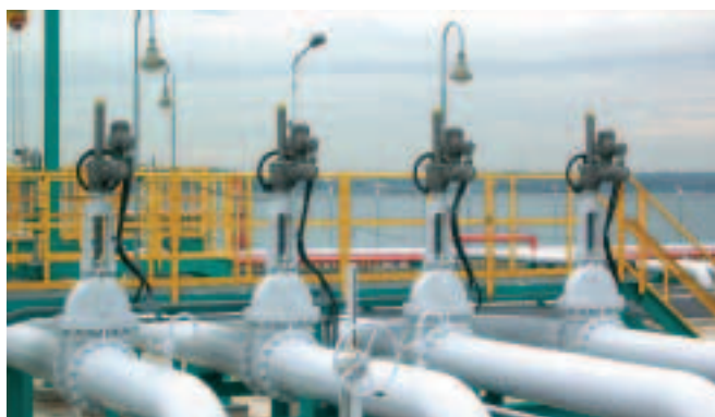
Приводы AUMA, установленные на клиновых задвижках. Топливная база в аэропорту Чубу, Япония
